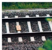
Ein wesentliches Element des ETCS ist die zwischen den Gleisen montierte Eurobalise.
