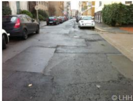
Schäden an der Straßenoberfläche
