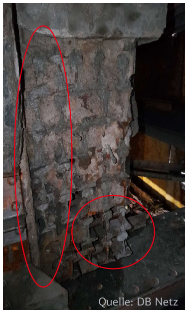
Statt Rissverpressung im Beton vorgefundene Abtrennung der Bewehrung ohne Halt
