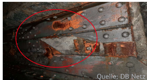
Verklammerung stark durchrostet, umfangreiche Erneuerung der Bereiche erforderlich
