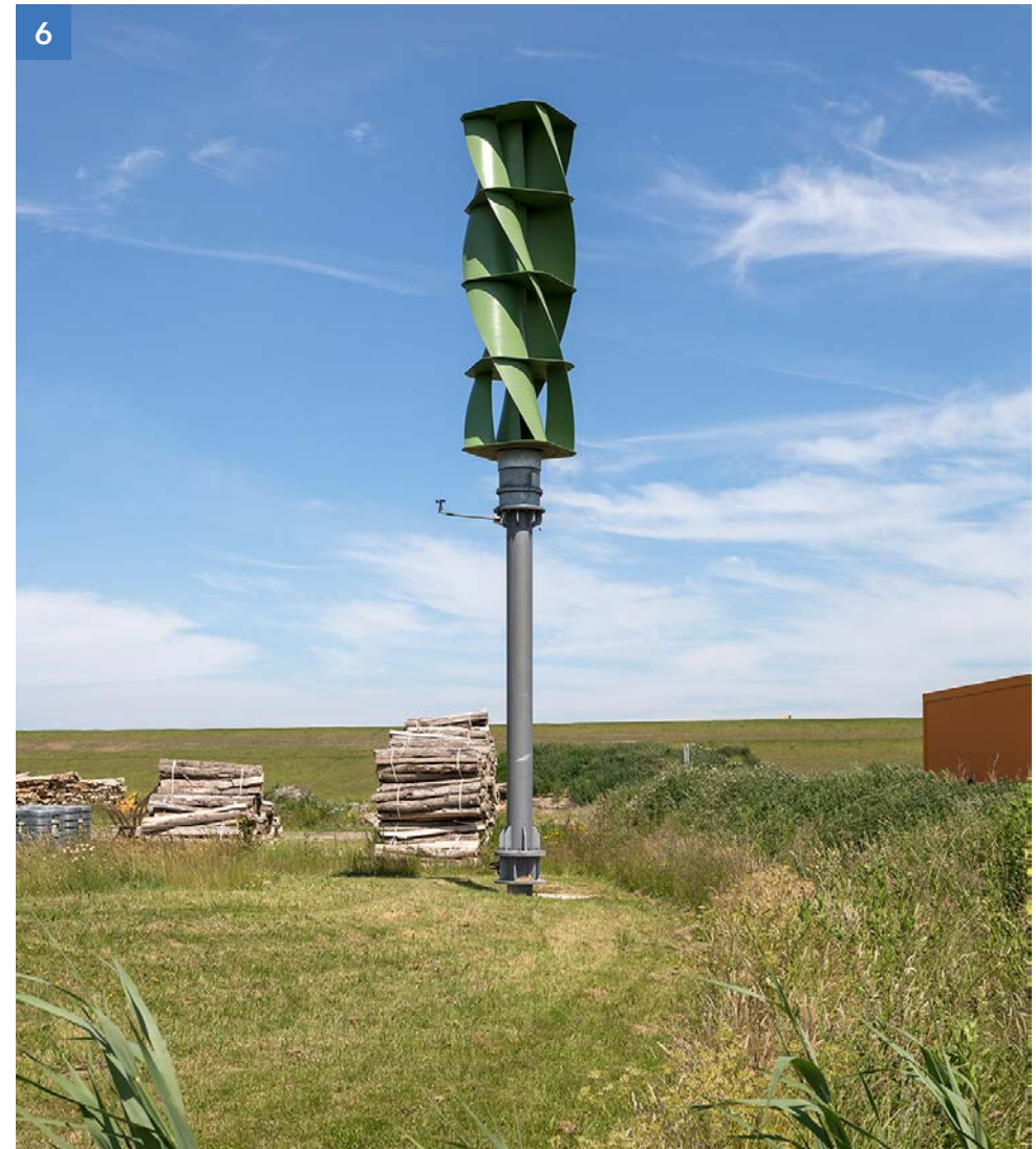
Abbildung 6: LKN.SH, Bauhof Norderhever, Windkraftanlage.
