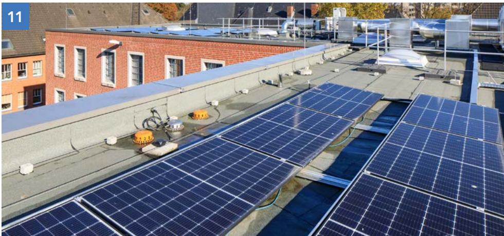
Abbildung 11: JVA Neumünster, Photovoltaikanlage auf Haus B.
