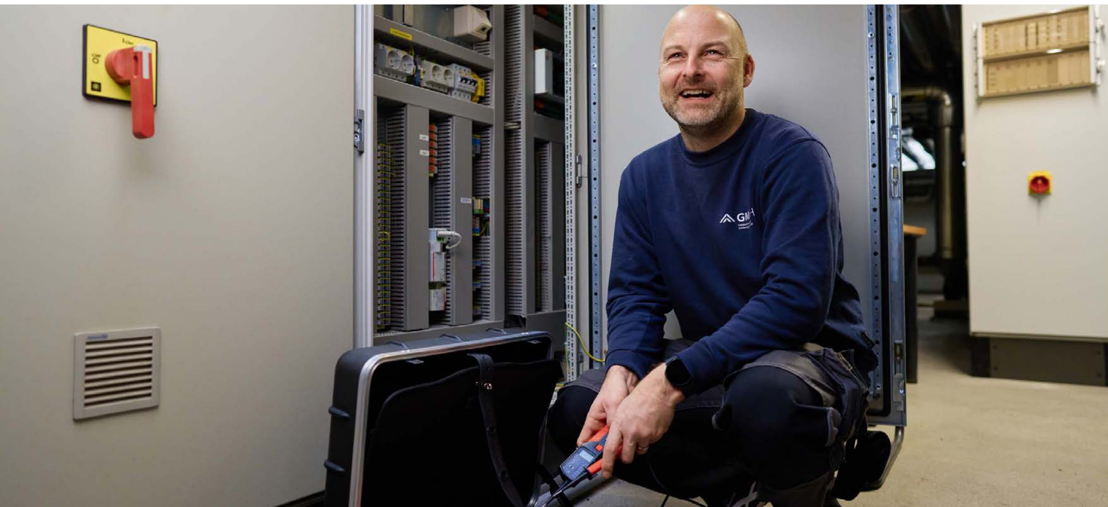
Abbildung 22: Die GMSH-Hausmeister kümmern sich um die technischen Anlagen.
